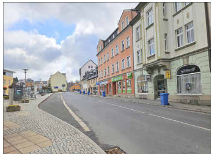
Zwischen Brühl und Gartenstraße laufen seit 20. April die Bauarbeiten. Sie sollen bis Ende Oktober andauern.
